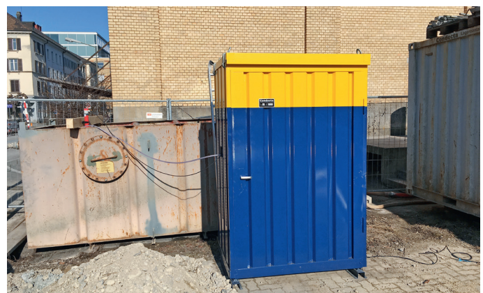
GSA-Steuerkabine mit bauseitigem Becken
