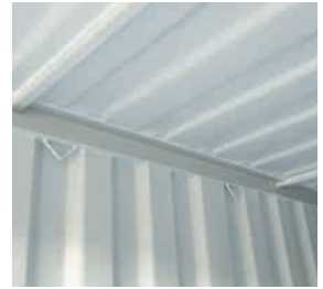
Festzurrhaken beidseitig am Dach
